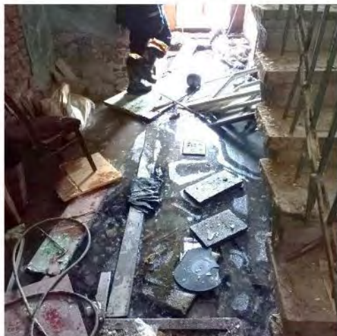
Фото 13. Затопление ч.п.1 и ч.п.2 пом.1.1К
