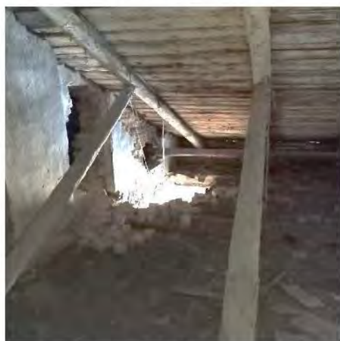
Фото 29. Вид на частичный провал перекрытия м/у чердаком и 3 этажом
