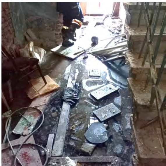
Фото 13. Затопление ч.п.1 и ч.п.2 пом.1ЛК
