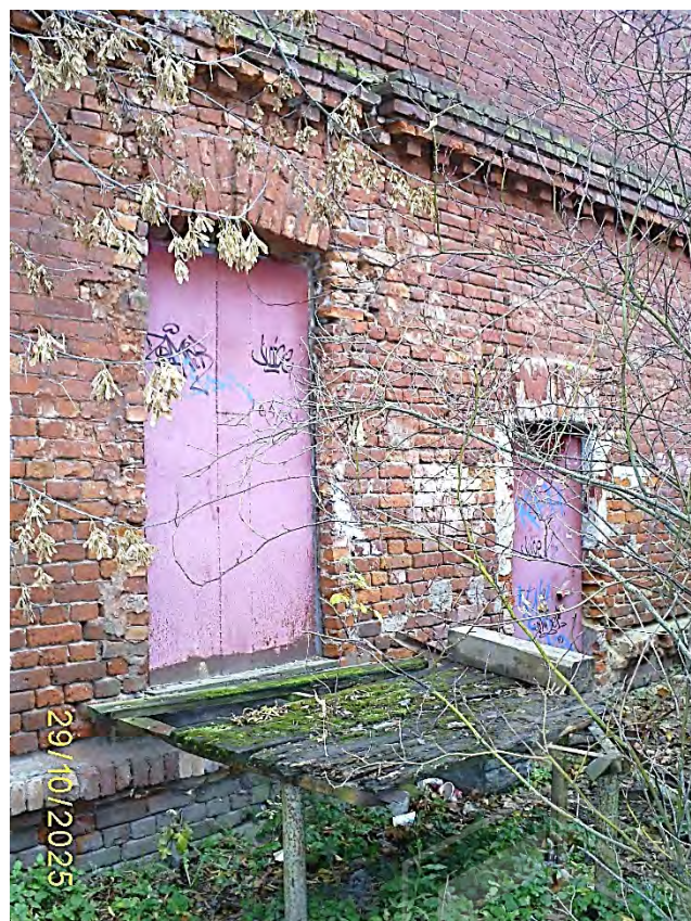
Фото 40. Часть восточного фасада со входами в ч.п.4 (коридор) и ч.п.1 (тамбур) пом. 1-Н
