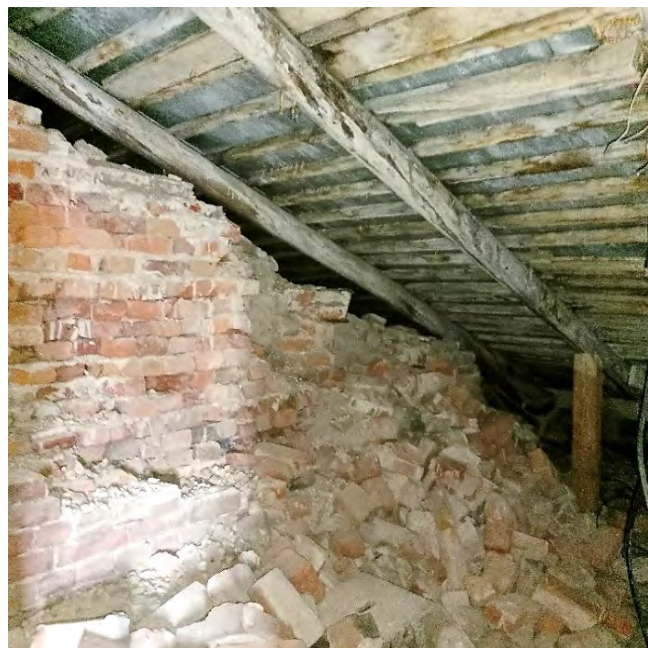
Фото 32. Вид чердачного (подкровельного) пространства, разрушение кладки
