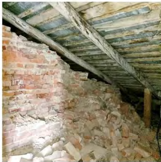
Фото 32. Вид чердачного (подкровельного) пространства, разрушение кладки
