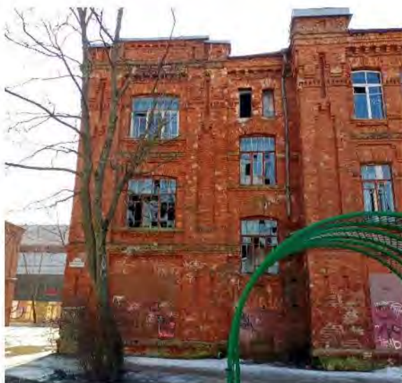
Фото 5. Вид на вход ч/з ч.п.1 (тамбур) пом. 1ЛК (восточная часть северного фасада)
