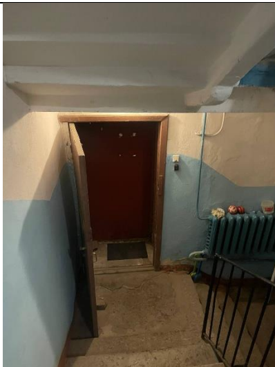
Фото № 15 – Внутреннее состояние помещения общего пользования (лестничная клетка)
