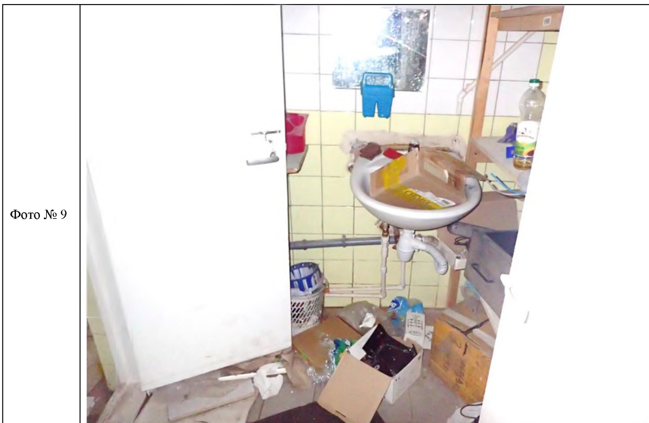
Описание: Вид внутри Объекта, находится бытовой мусор
