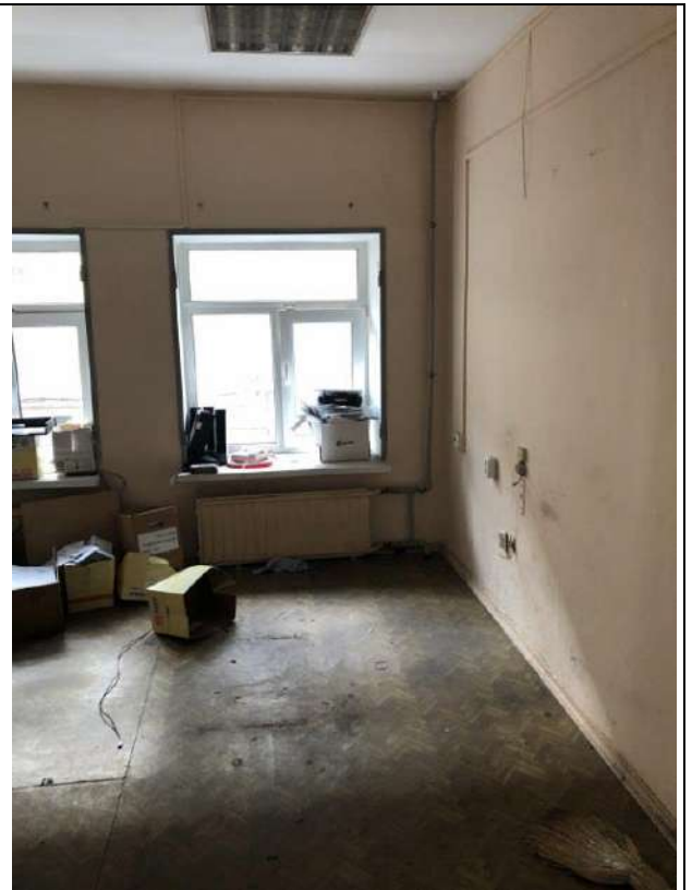
Фото 54. Состояние внутренней отделки пом. 3-Н (второй этаж)
