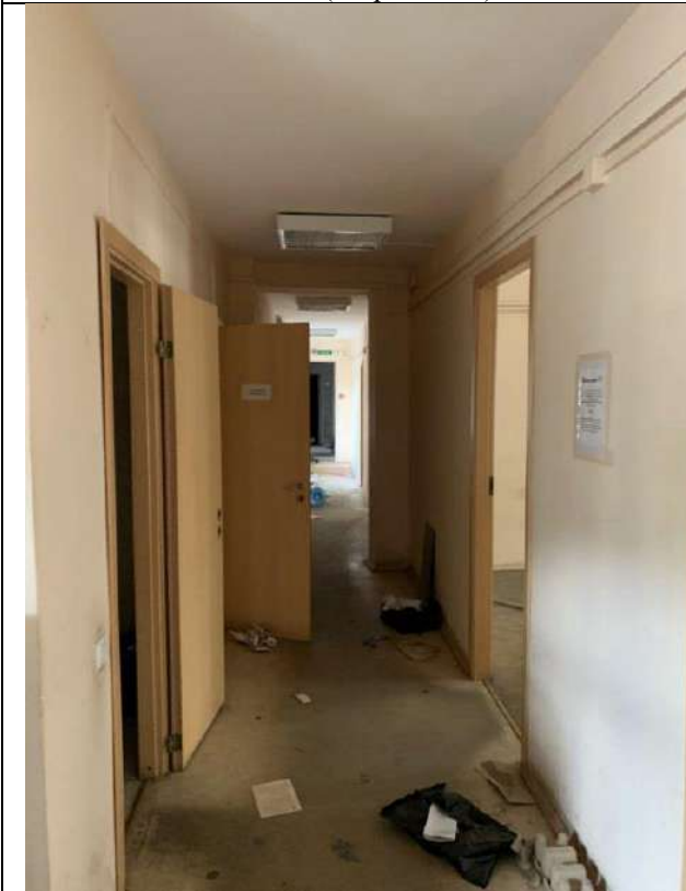
Фото 39. Состояние внутренней отделки пом. 3-Н (второй этаж)
