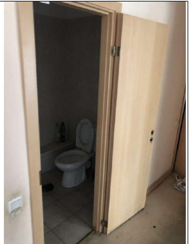
Фото 42. Состояние внутренней отделки пом. 3-Н (второй этаж)
