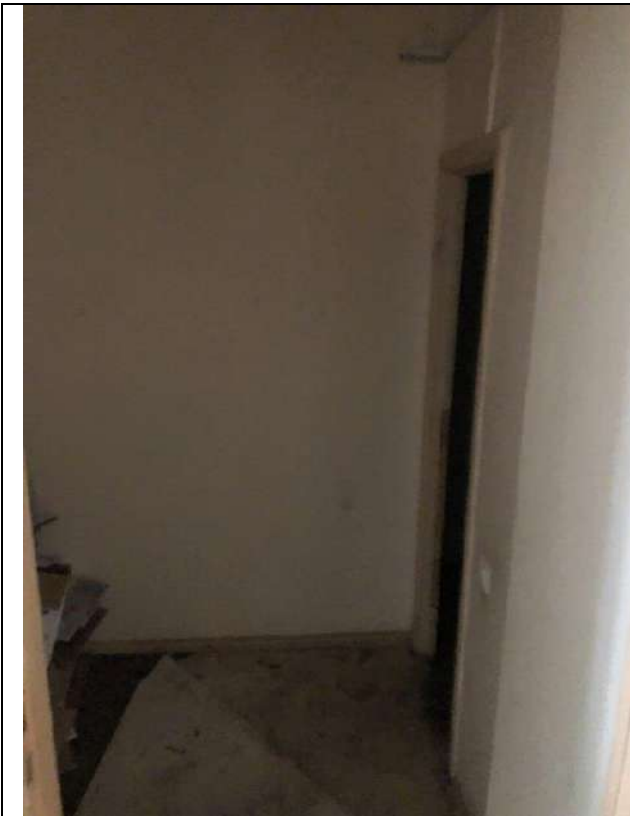
Фото 21. Состояние внутренней отделки пом. 3-Н (первый этаж)
