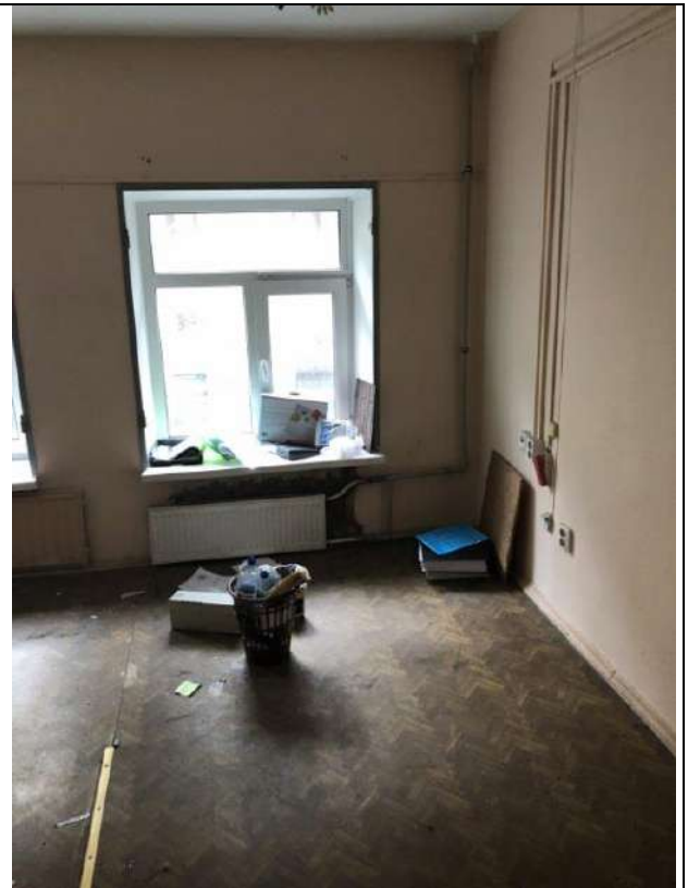
Фото 46. Состояние внутренней отделки пом. 3-Н (второй этаж)
