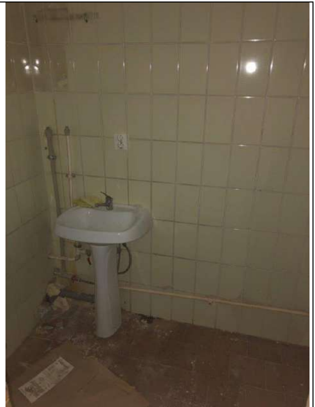
Фото 22. Состояние внутренней отделки пом. 3-Н (первый этаж)
