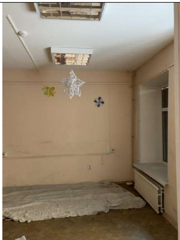
Фото 14. Состояние внутренней отделки пом. 3-Н (первый этаж)
