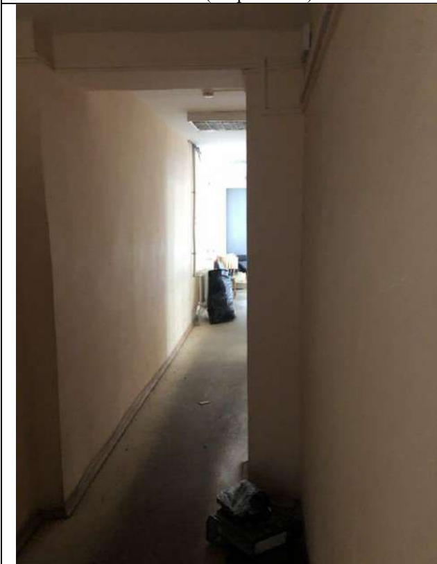
Фото 47. Состояние внутренней отделки пом. 3-Н (второй этаж)
