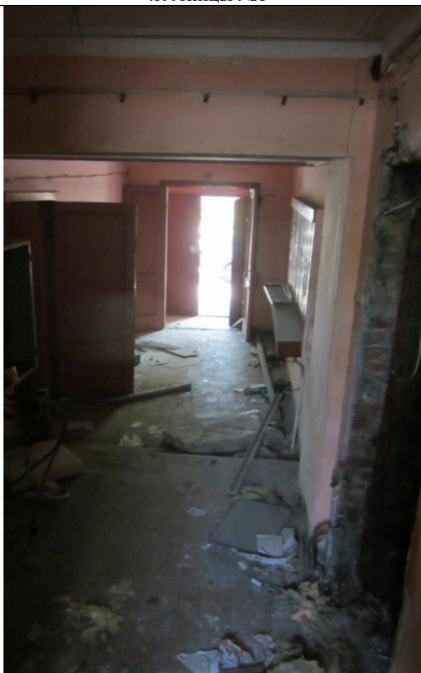
Фото 31. Состояние лестничной клетки №1
