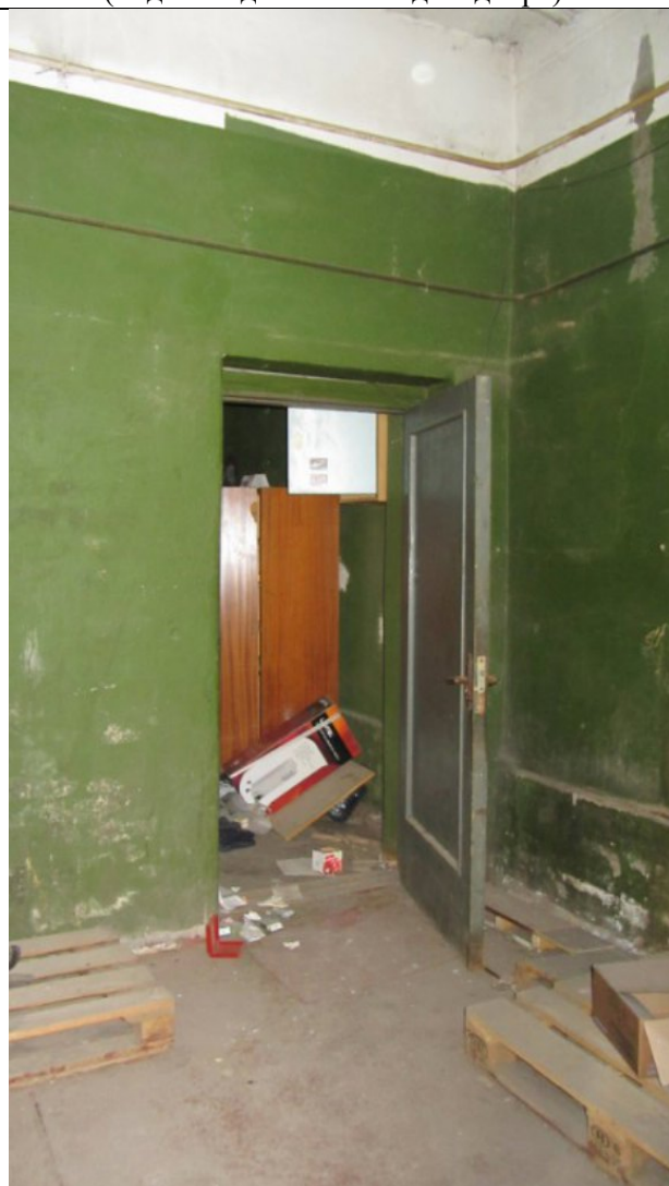
Фото 42. Состояние ч.п.1 пом. 4С-Н (проход в ч.п. 3)
