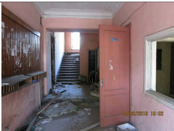
Фото 33. Состояние лестничной клетки №1
