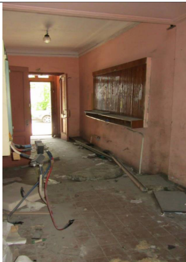
Фото 30. Состояние лестничной клетки №1
