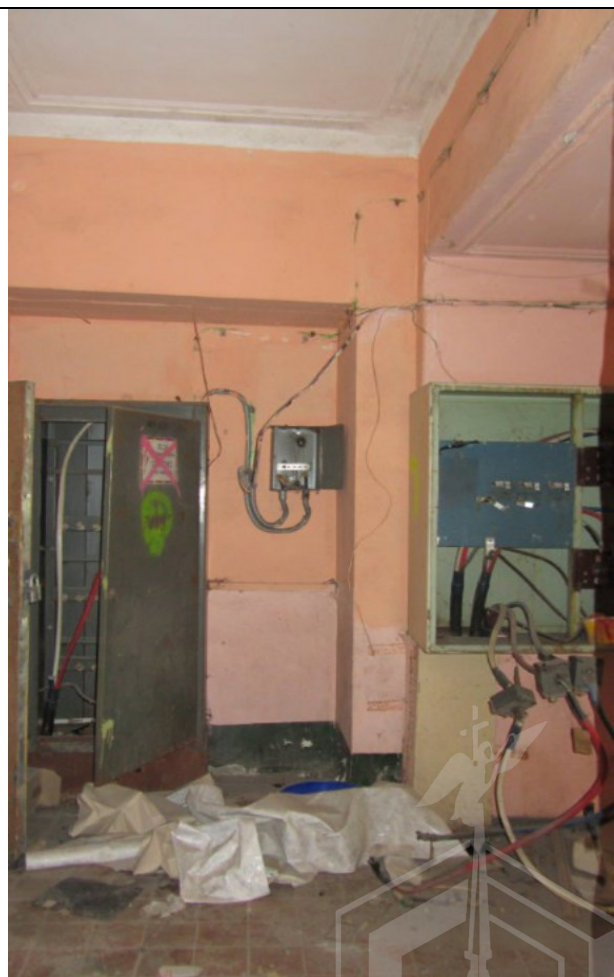
Фото 32. Состояние лестничной клетки №1
