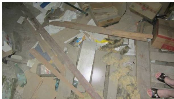
Фото 44. Состояние ч.п.1 пом. 4С-Н (пол)
