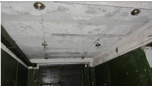
Фото 43. Состояние ч.п.1 пом. 4С-Н (потолок)
