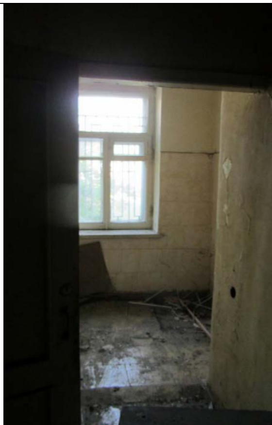
Фото 97. Состояние ч.п.1 пом. 2С-Н (вид на ч.п.3)
