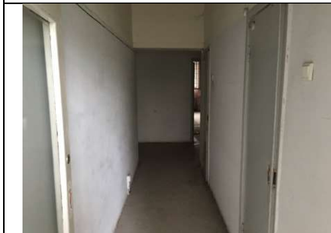
Фото 23: Ч.п.9 вид на ч.п.8 Самовольная перепланировка: расширен дверной проем между ч.п.9 и ч.п.8; отсутствует дверное полотно, обозначенное на плане
