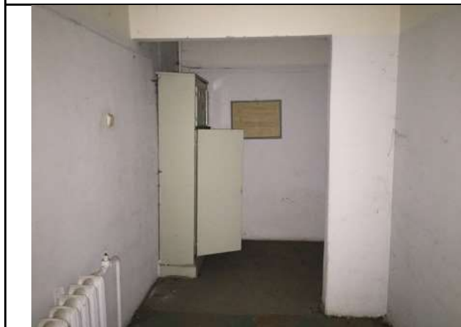
Фото 21: Ч.п.7, вид на ч.п.4. Самовольная перепланировка: расширен дверной проем; отсутствует дверное полотно, обозначенное на плане
